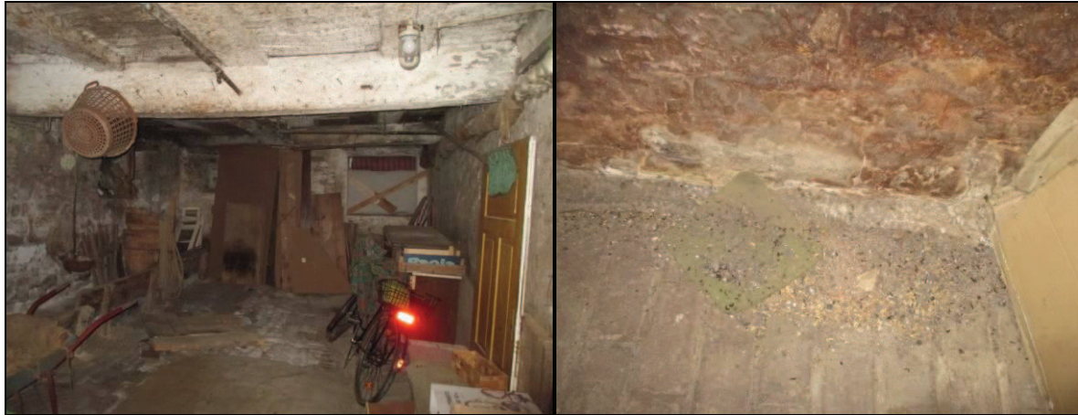
Abbildung 4 Ehemalige Stallungen im Erdgeschoss (links), Kotspuren Fledermäuse am Fuß der Rückwand (rechts).
