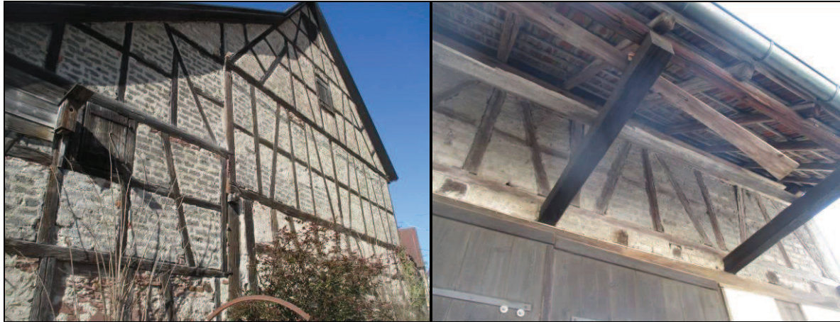
Abbildung 6 Scheunengebäude, Ostfassade (links), überstehendes Dach auf der Nordseite (rechts).
