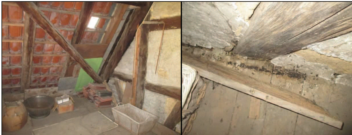
Abbildung 3 Räume im Obergeschoss (links), Kotspuren Fledermäuse am Boden hinter einer angelehnten Holzplatte (rechts).
